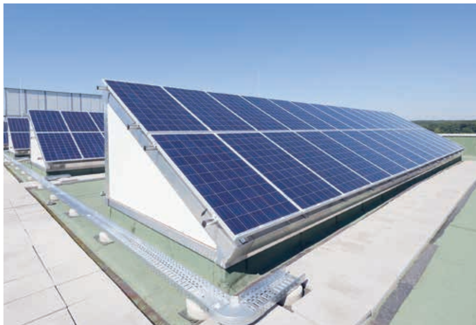
Nachhaltige Gebäudewirtschaft: mit Solaranlagen und energieeffizientem, klimastabilen Mauerwerk.
